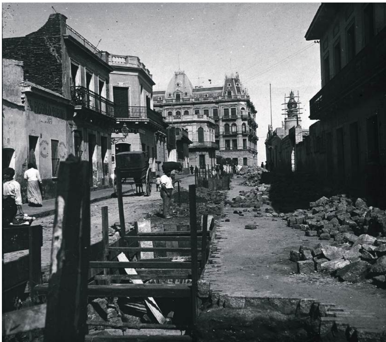
Figura 13. Colector secundario de la calle Guaraní. Al fondo el Hotel Nacional (fotografía de Jesús Cubela, Centro de Fotografía de Montevideo).
