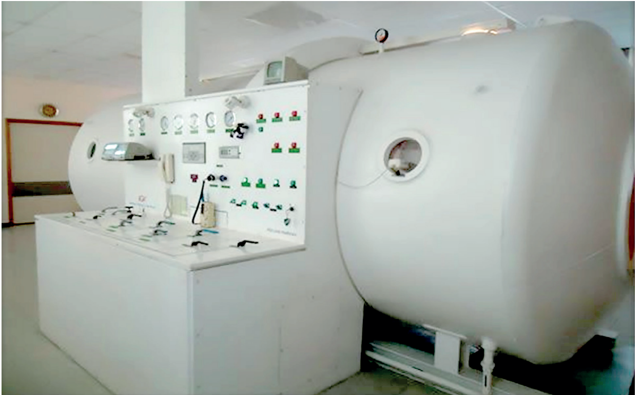
Figura 2A. Cámara hiperbárica multiplaza. Hospital Central de las Fuerzas Armadas, Montevideo, Uruguay.
