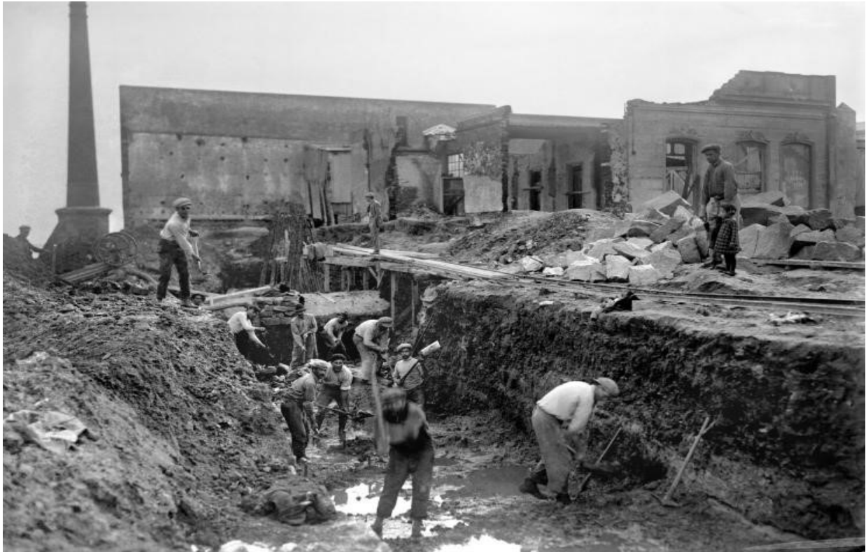
Figura 14. Chimenea de ventilación del colector principal, calle Guaraní durante la construcción de la Rambla Sur entre 1923-1935 (Centro de Fotografía de Montevideo).
